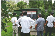
集团水电班配合物业自查箱式变电站
